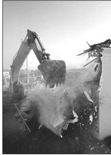
Destruction d'une maison de la colonie juive de Katif le 21 août 2005
